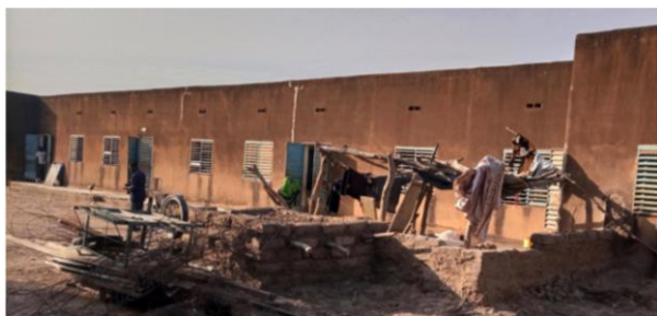
Bild: Undichtes Dach setzte Räume unter Wasser.
